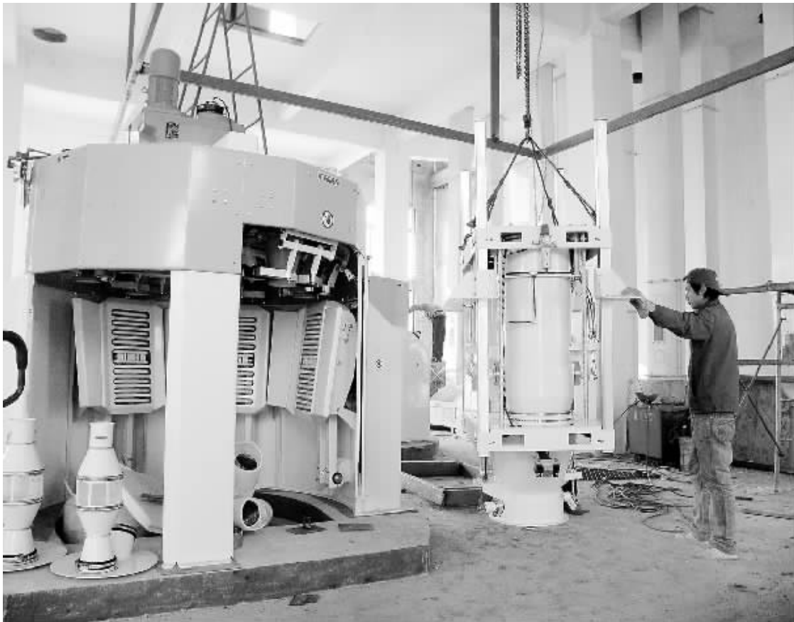
随着五得利三期工程紧张组装试生产,位于我市经济开发区的五得利公司将成为全球最大的单体面粉生产企业,日产小麦面粉3600吨。图为工人正在紧张安装设备。(记者 刘彦章 摄)
