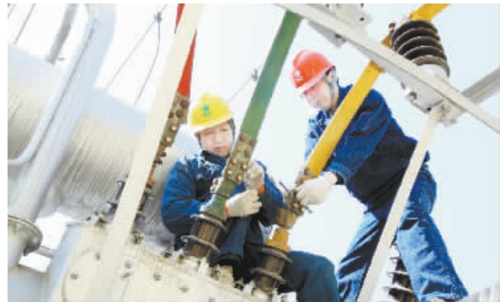
4 月 10 日，项城市电业局工作人员在 35 千伏工业变电站进行预防性试验，为设备“把脉问诊”，消除隐患，精心预试迎峰度夏。
