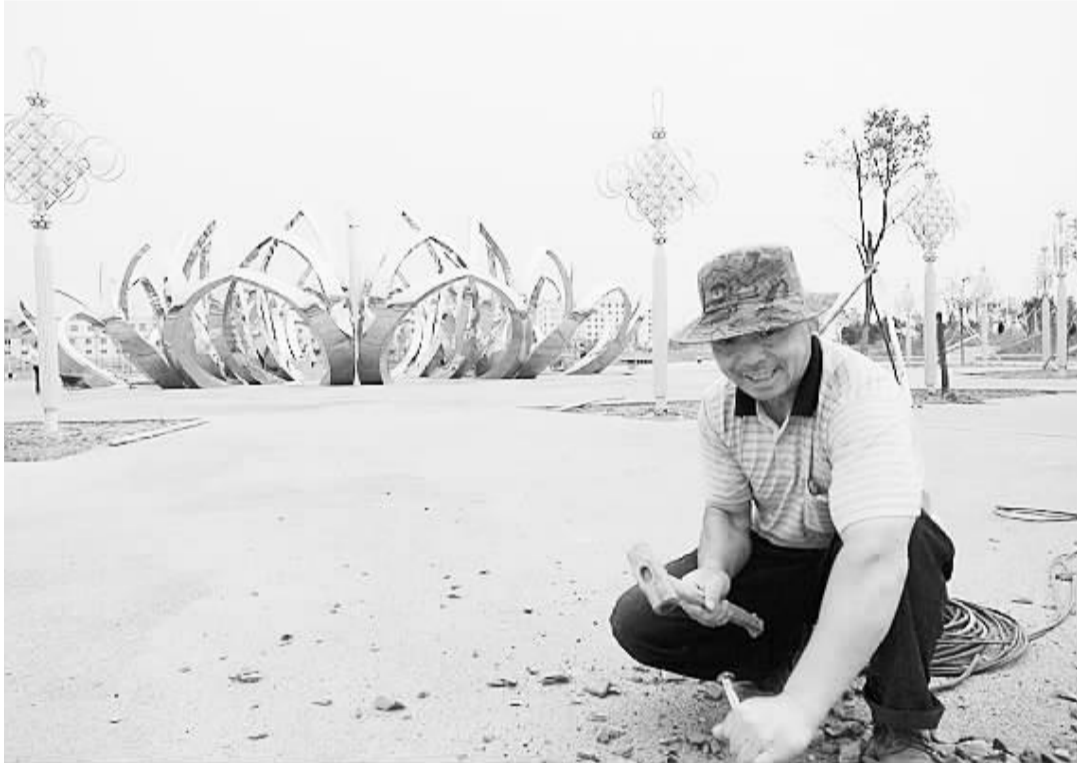
项城市册马沟整治项目一期工程投资4500万元,两侧是50~70米的风景绿化带,并进行水系改造、清淤净底、绿化景观建设,建成后将成为市民休闲休闲娱乐场所。图为一名工人正在册马沟广场整修路面。(赵献伟 摄)
