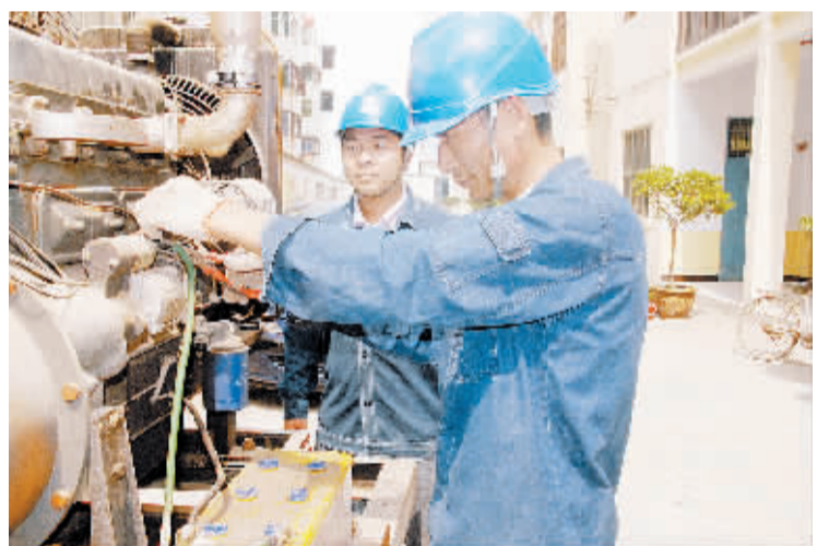
近日,扶沟县供电公司对有考试保电任务的3个变电站、5条输电线路及各考点、宾馆等重要用电场所的配电设施,进行全方位隐患排查,并配备7台大功率发电机,做好应急供电保障工作。图为该公司保电人员在城关镇一中考点对应急发电车进行检测。 王泉林 刘军胜 摄
