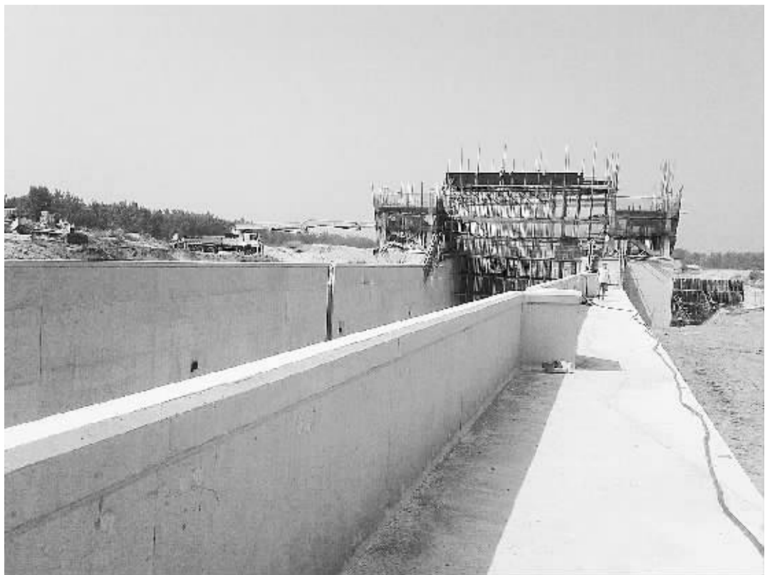
作为市“双十五工程”之一的漯河航运开发建设二期工程项目,开工以来已累计完成投资4.06亿元。今年计划完成投资1.8亿元,截至8月中旬,已完成年度投资1.26亿元。图为漯河航运建设项目武船闸施工现场。(记者 吴继峰 摄)
