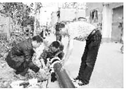
金海路办事处及自来水公司工作人员正在为张埠口行政村群众安装上水管道。
