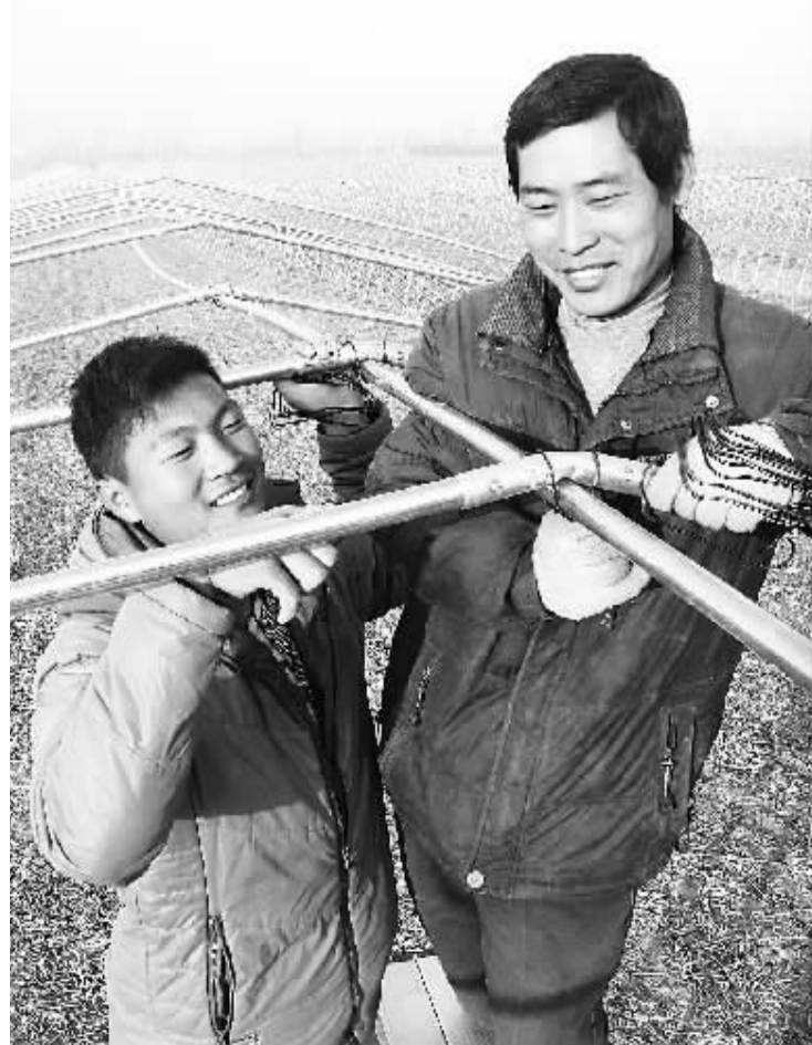
扶沟县今年新建500亩以上的蔬菜园区13个,新增保护地栽培面积1万亩。图为该县的建棚专业队在练寺镇建设钢架大棚。(谷志方摄)
