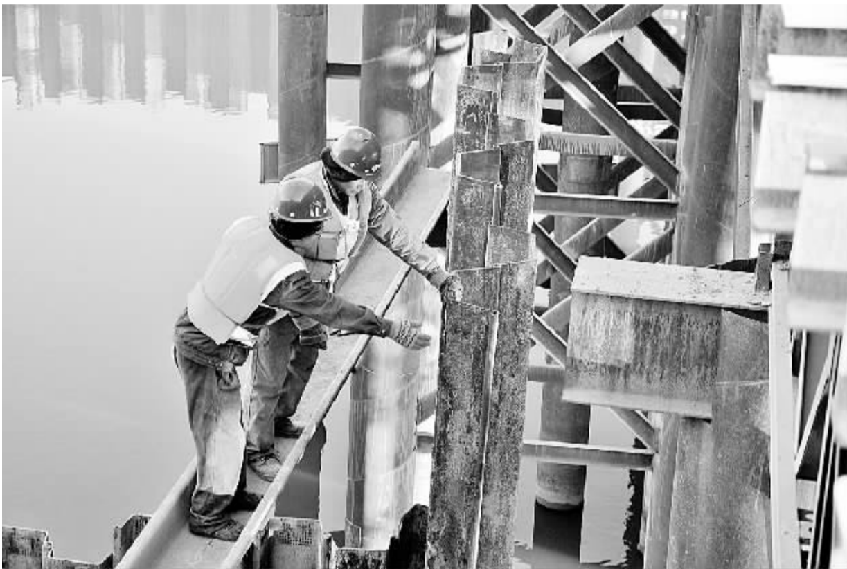
昨日,两名工人在东环路跨沙河大桥施工现场检查工程质量。为了确保大桥如期交付使用,施工方组织人员顶着寒风加班加点工作在一线。(记者 沈湛 摄)
