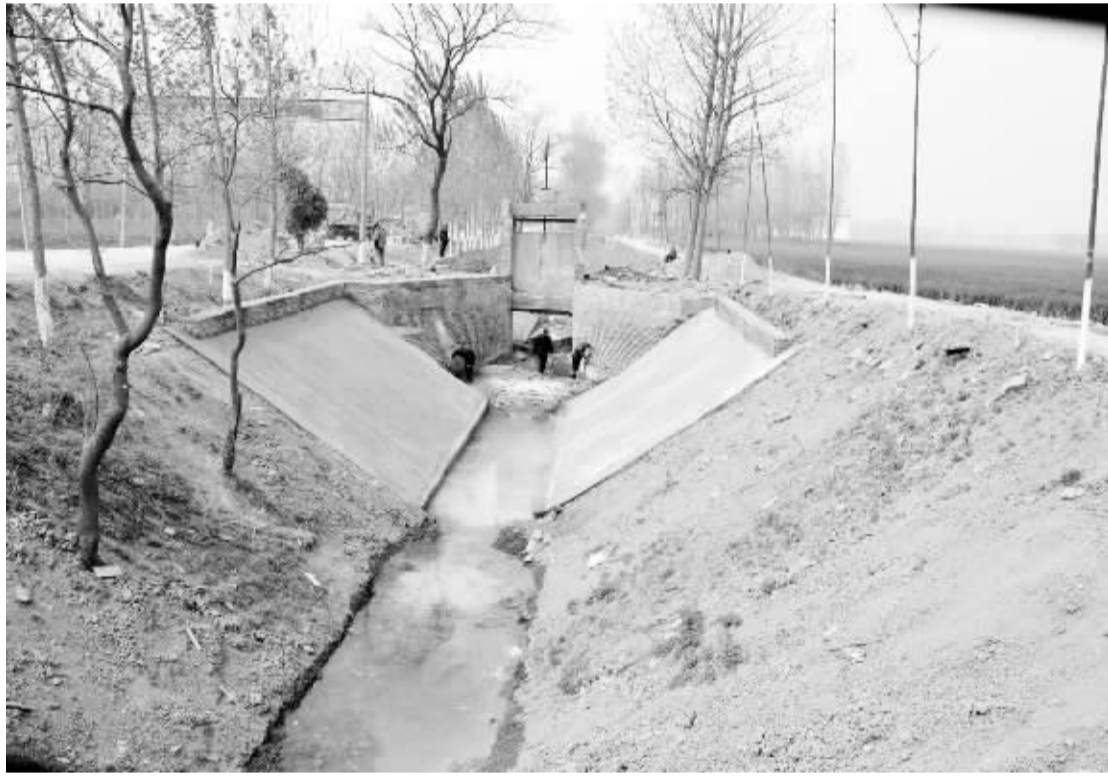
总投资2968.24万元的小型农田水利建设,使沈丘县新增灌溉面积2.11万亩,改善灌溉面积0.91万亩,新增除涝面积0.61万亩,改善除涝面积2.41万亩,年增粮食生产能力149.8万公斤,农民年人均增收112.66元。图为该县洪山乡申马庄行政村干渠工地上,工人们正在整坡固堤,疏浚沟槽。
