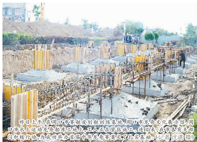
昨日上午,在周口市赛艇皮划艇训练基地,周口市龙舟文化展示馆、周口市水上运动龙舟船库工地上,工人正在紧张施工。连日来,我市各有关部门积极行动,为成功举办首届中华龙舟赛奠定了坚实基础。(记者 沈湛摄)
