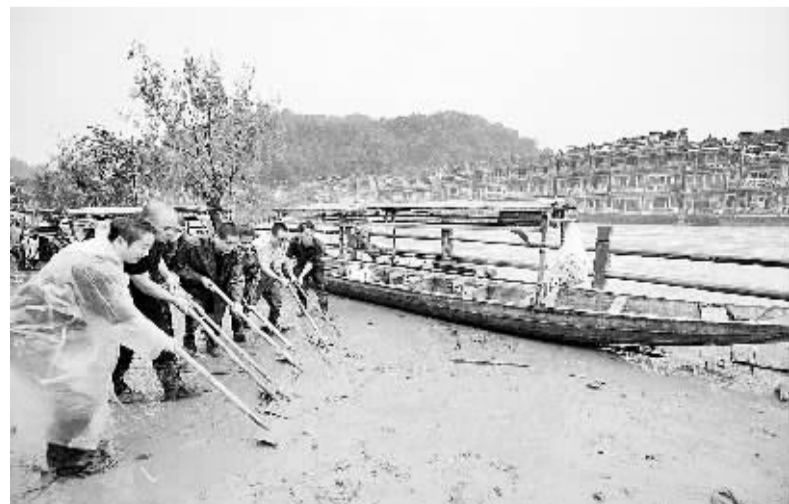
湖南凤凰:洪水退去 全城清淤 7月17日,凤凰当地群众在沅江沿岸清理淤泥杂物。随着雨势减弱,湖南凤凰古城内局地洪水已逐渐消退,之前被淹的商铺开门清理淤泥和杂物,救援人员也同时对街道进行清淤和消毒。 新华社记者 白禹 摄
