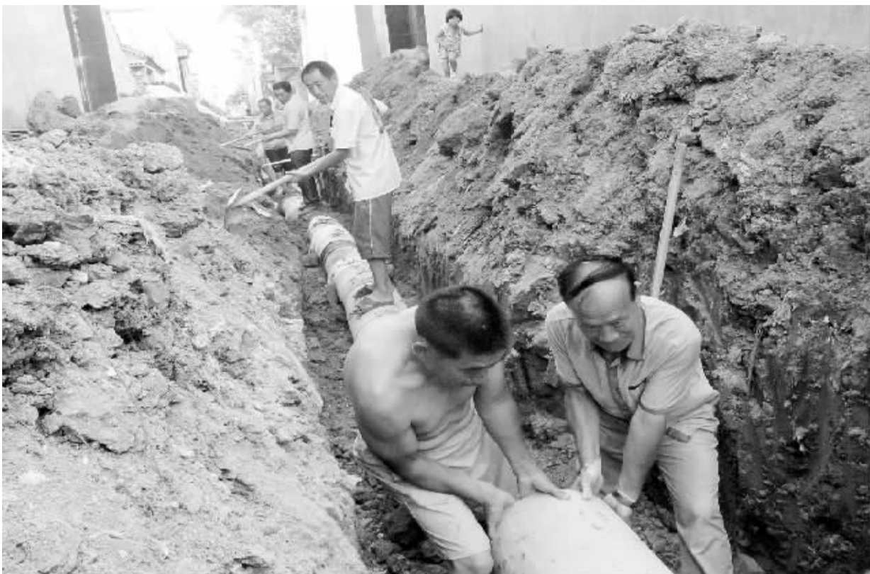
7月22日,商水县舒庄乡高庄村党支部书记王海秋带领6名党员干部为拐子自然村的群众修筑下水道。近两天来,该村6名党员干部冒着酷暑义务为群众修筑下水道。在开展党的群众路线教育实践活动中,该乡纪委驻村工作队跑项目、跑资金,为该村修筑了水泥路和下水道,解决了群众走路难和雨天排水难问题。(乔连军 摄)
