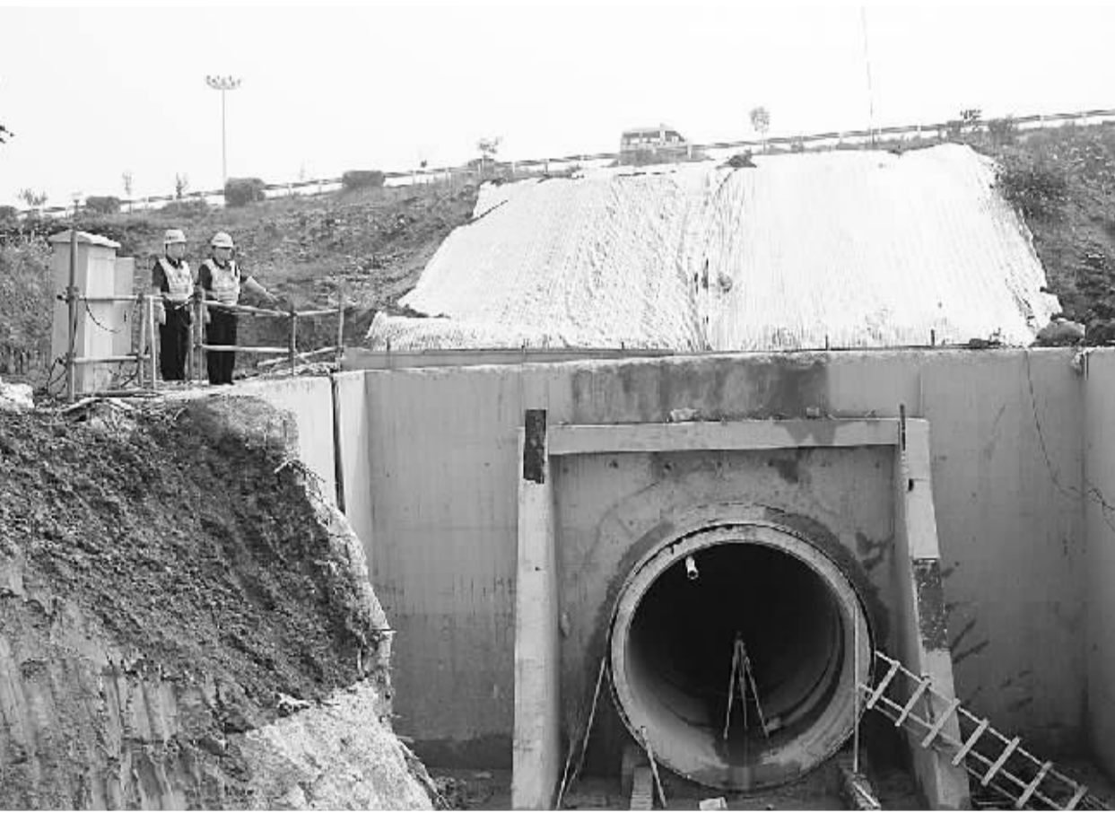
近日,南水北调受水区周口供水配套工程项管穿越周商高速周口段正式开工建设。为此,高发公司周口分公司本着“施工服从于保通、保通服务于施工”的原则,全力以赴为南水北调穿越高速公路施工保驾护航,确保施工期间车辆通行秩序良好和高速公路路面路基不受影响。(记者王映摄)
