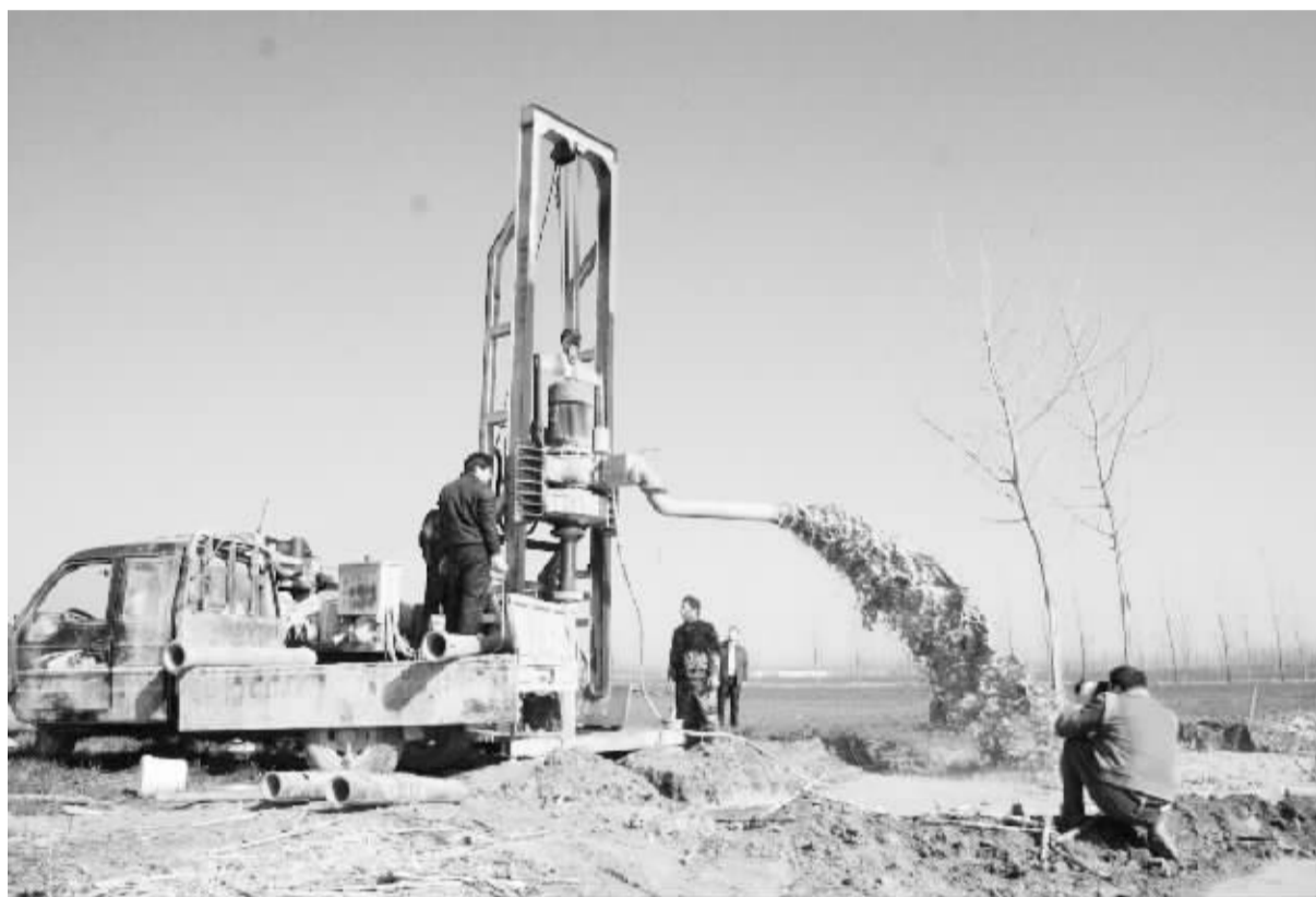
入冬以来, 商水县汤庄乡党委和政府以打造农建精品工程为目标, 以完善农业基础设施建设为重点, 突出“早”字, 做到规划早、宣传早、施工早, 不断打造农建精品工程。截至目前, 全乡已出动机械3000台次、人力10000人次, 整修道路28条63公里, 新打机井1080眼, 维修桥涵110座, 动土方30万立方米。图为施工人员正在进行打井作业。
