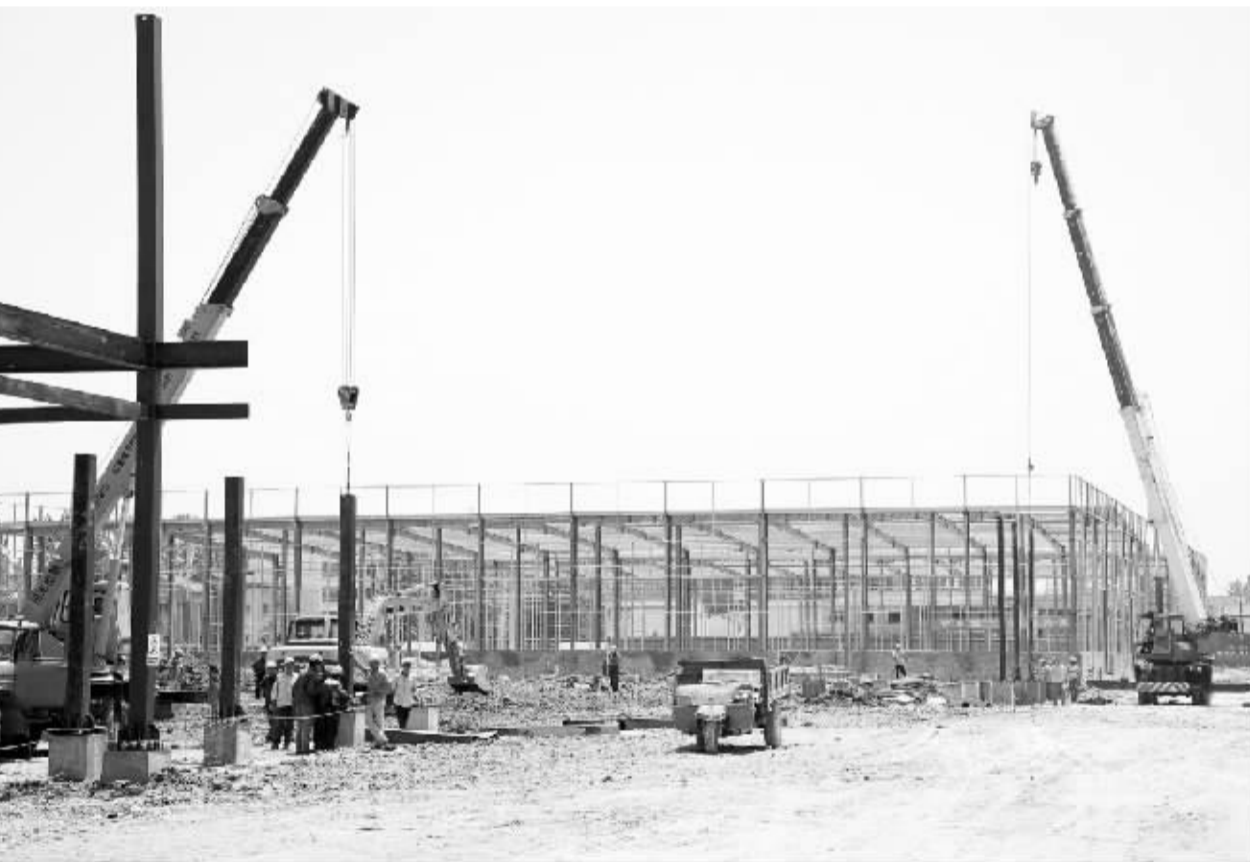
昨日,在沈丘县产业集聚区内,九泉红木家具有限公司新上项目主体设施正在紧张施工中。近年来,沈丘县产业集聚区不断引进新的企业落地生根,壮大产业集群规模,为沈丘县产业集聚区注入了无限活力。(记者 王映 摄)
