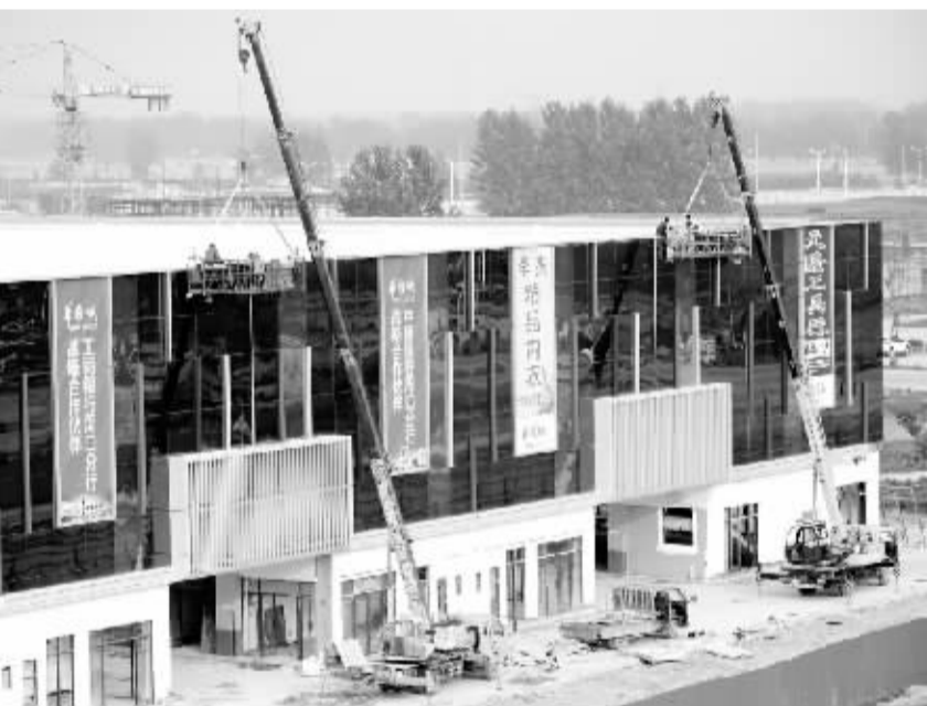
昨日,周口华耀城项目工地正在紧张施工。该项目是我省A类重点建设项目,规划总占地面积约10平方公里,建筑面积约1000万平方米,包括交易市场、仓储物流、商务配套和生活服务配套四大部分。项目完全建成后,将创造4万个就业机会,10万个就业机会,成为集商贸交易、物流集散、展示推广、信息交流、电子商务等九大功能于一体的超大规模综合商贸物流中心。
