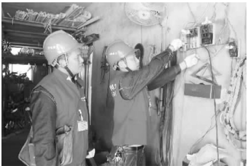
针对夏季用电负荷增大,安全隐患增多的实际,7月23日,太康县供电公司组织党员服务小分队,登门入户帮助客户检查室内用电线路。
