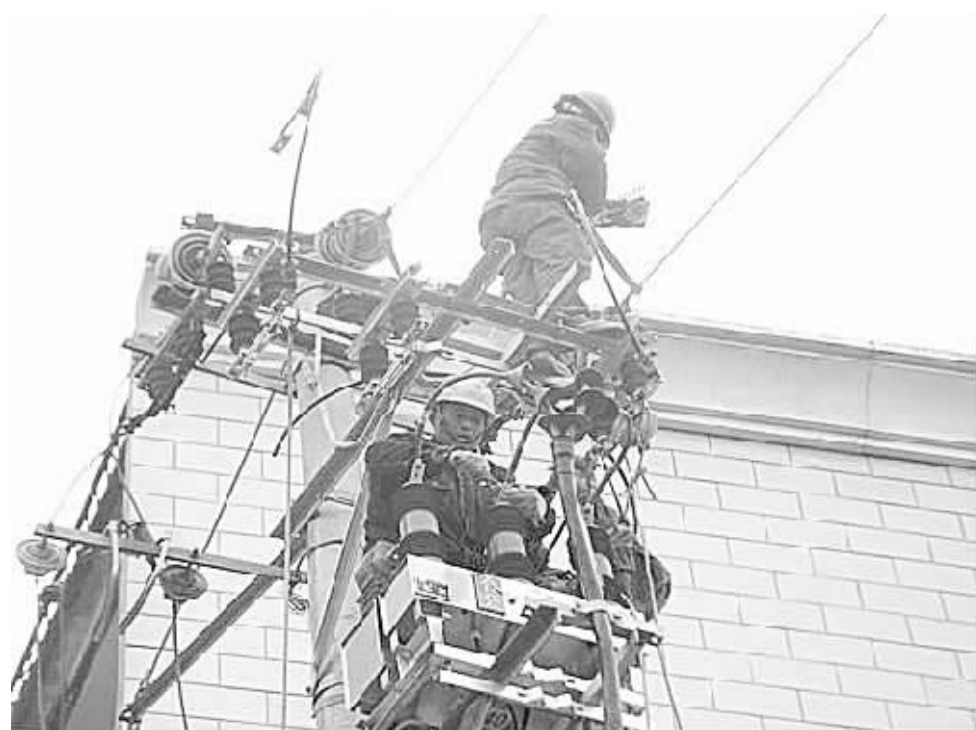
11月8日,郸城县供电公司组织安装人员对南丰镇支线线路进行升级改造,以确保冬季用电安全。
