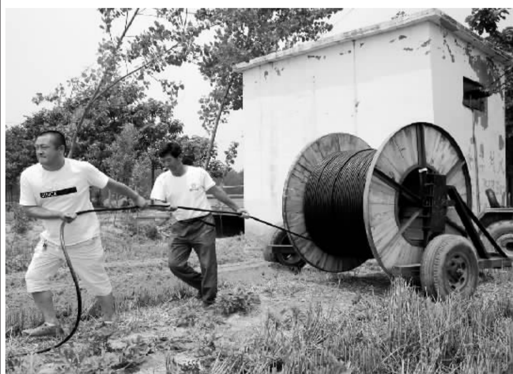
扶沟县加大高效节水灌溉工程建设力度,增加高标准农田建设示范田。图为工人在崔桥镇开槽敷设低压线路。张力友 摄
