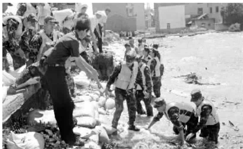
江西鄱阳张家圩塌方60米 武警特战队员4小时排除险情 7月21日,武警江西总队特战队员集训队官兵在技术人员的指导下涉水加固大堤。当日,受连日超警戒水位影响,江西省鄱阳县双港镇张家圩大堤出现塌方险情,塌方处长约60米。武警江西总队特战队员集训队60名官兵紧急赶赴现场,在技术人员的指导下,经过4小时的连续奋战,塌方险情得到有效控制。
