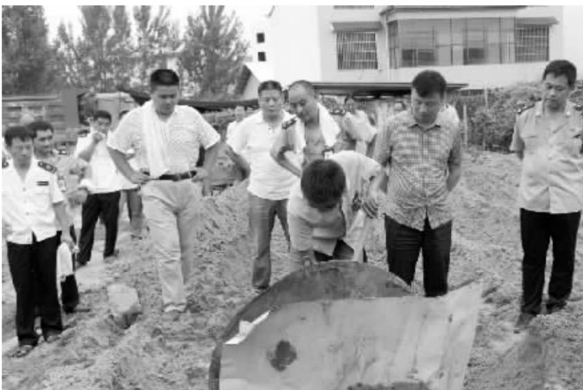
扶沟县抽调公安、质监、商务、工商等13个部门组成综合执法队，开展取缔非法加油站（点）。此次行动强行拆除非法加油站（点）30个。 卢付昌 摄
