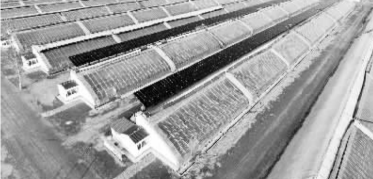
荒山荒坡上“收获太阳” 这是3月21日拍摄的山西省天镇县同煤光伏扶贫电站一角。山西省天镇县地处黄土高原北部,光照资源充足,荒山荒坡广阔,建设光伏电站具有得天独厚的优势。近年来,当地通过在荒山荒坡上建设光伏电站推进脱贫攻坚,有效帮助了贫困人口增收。截至目前,天镇县光伏扶贫电站总装机容量达52.3兆瓦,预计年均发电量约0.78亿千瓦时。新华社发
