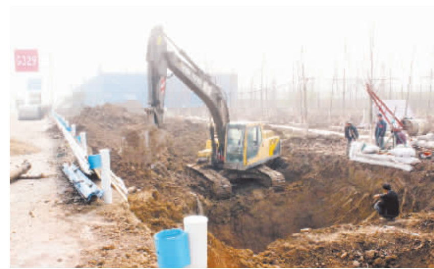
近日,南环路扩宽工程项目工地上大型机械车辆来回穿梭,施工工人干得热火朝天,一派热闹景象,该项目正在以高标准、快节奏整体推进中。王洁石 摄
