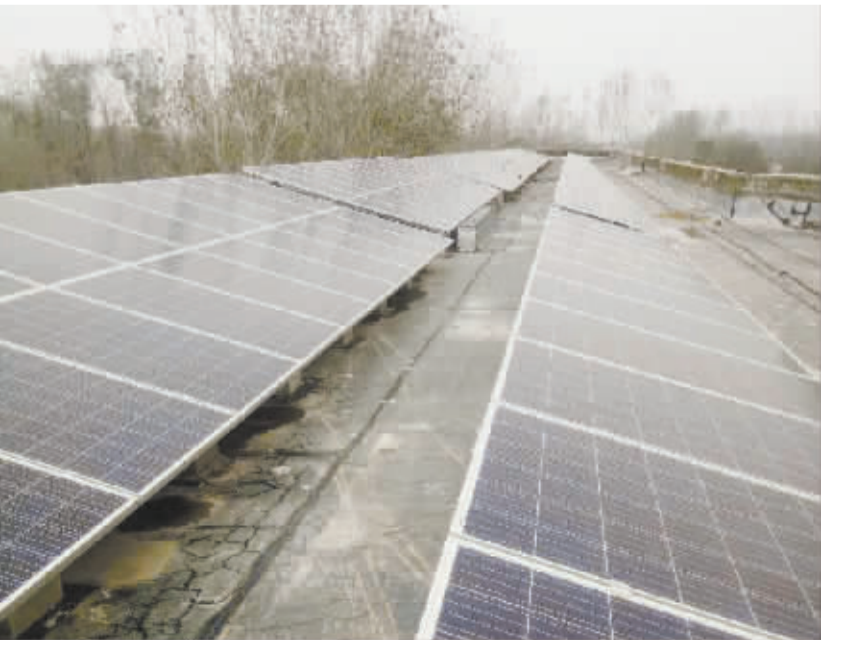
脱贫攻坚开展以来,西华县东夏镇按照县委、县政府部署,积极探索精准扶贫新模式,助推光伏产业创新发展新应用,在全镇投资1700万,规划建设13个台区光伏发电项目,共计2.12兆。该镇已在两个贫困村建好两个光伏发电项目,预计年底能全部建成并入电网投入使用。图为记者近日拍摄的该镇北街行政村刚刚建成的光伏发电项目一角。记者 张猛 通讯员 邓亚丽 摄
