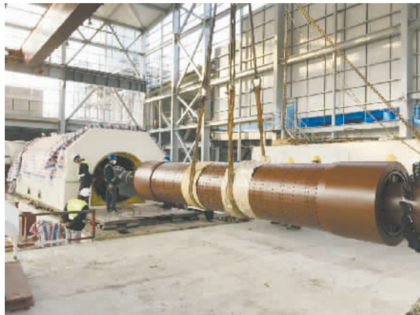
12月6日,周口燃气电厂1号汽轮发电机顺利完成穿转子工作,为下一步整机安装创造了条件。汽轮发电机采用上海电气集团生产的空气循环冷却发电机,发电机转子重47吨,采用行车配备专用工具穿装就位。 范秋明 摄
