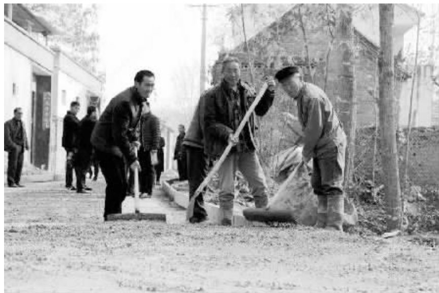
扶沟县交通运输局驻村工作队从群众的基本需求出发,积极推进所驻村基础设施建设,帮助村里修建了主要道路,建设了学校教学楼、新建了村室和卫生室,解决群众出行难、就医难、入学难、排水难等问题。图为所驻村张坞岗村主干道正在施工建设。纪俊辉摄
