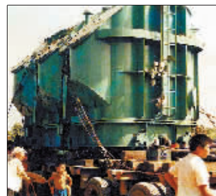
1987年5月,周口第一台220千伏主变进站。
