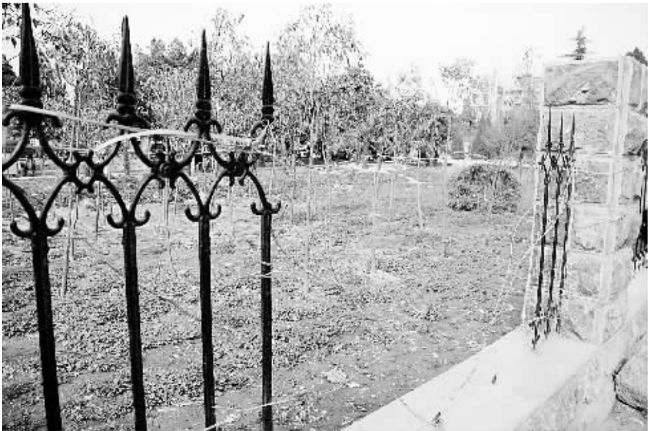
昨天，周口人民公园临七一路的围墙受损，十几根工艺铸铁栅栏被盗。据了解，这些工艺铸铁栅栏刚装好不久。
