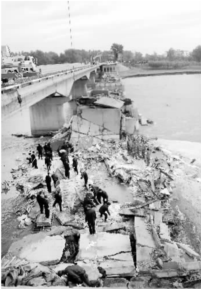
▲ 工作人员正在清理呼兰河大桥坍塌事故现场
