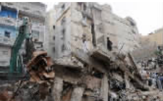
救援人员清理楼房坍塌现场。
