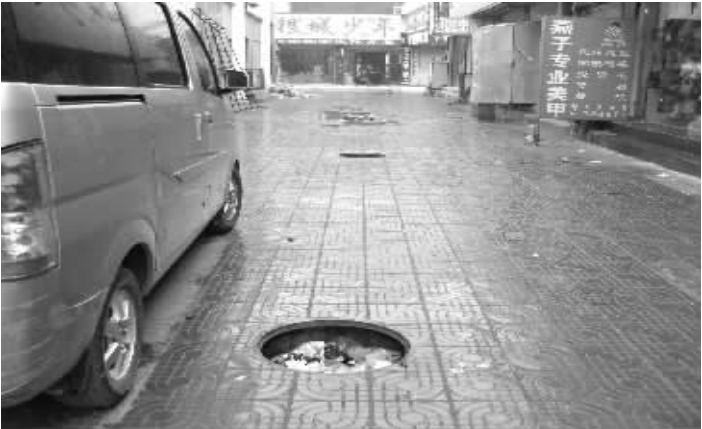
太康县天才幼儿园附近的两个窖井没有井盖,存在一定安全隐患。附近居民希望有关部门能尽快处理这两个“张嘴”的窖井。
