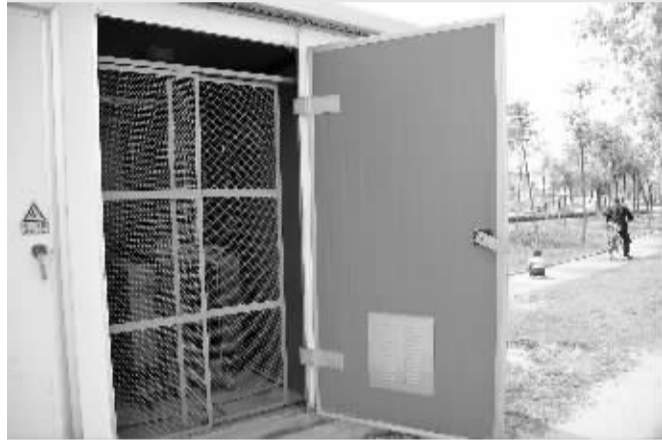
昨日下午,市区汉阳路东侧的滨河公园内,一座变电器室的门打开着,里面的变电器、电线清晰可见。这儿经常有孩子到附近玩耍嬉戏,一旦不慎触摸,后果不堪设想。希望有关部门能及时修复,消除安全隐患。
