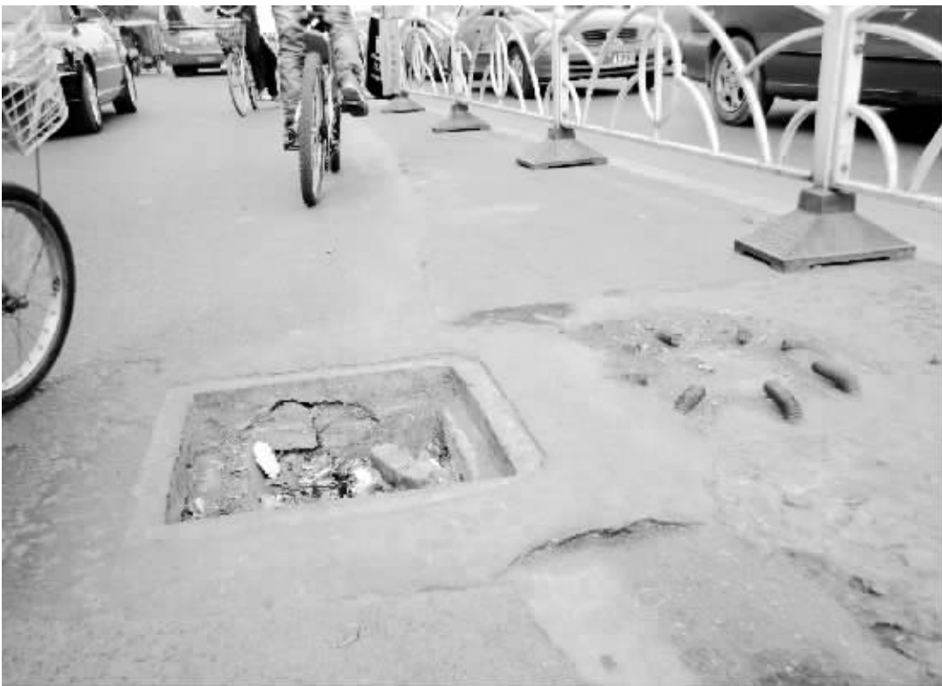
交通路与八一路交叉口处破损窨井盖。晚报记者 程文琰 摄
