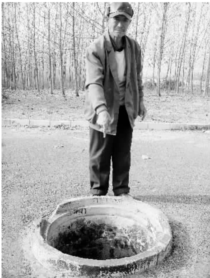
工农南路与淮河路交叉口西北角处一窨井的井盖不翼而飞。
