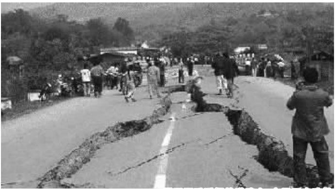
震区严重受损的道路上,灾民正在疏散
