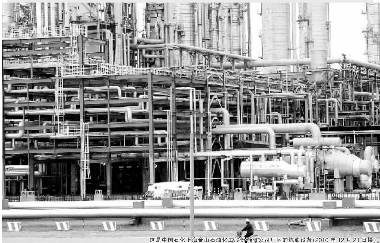
这是中国石化上海金山石油化工股份有限公司厂区的炼油设备(2010年12月21日摄)。
