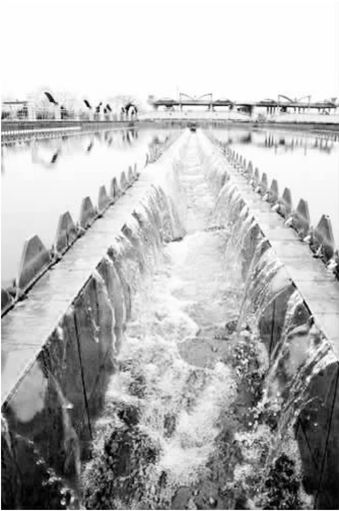
目前,广西柳州市自来水厂已启动应急预案,针对除镉调整处理工艺,加强水质处理过程中的监测。图为 1 月 31 日,柳州市柳西水厂自来水处理系统正在运行中。 新华社记者 陆波岸 摄
