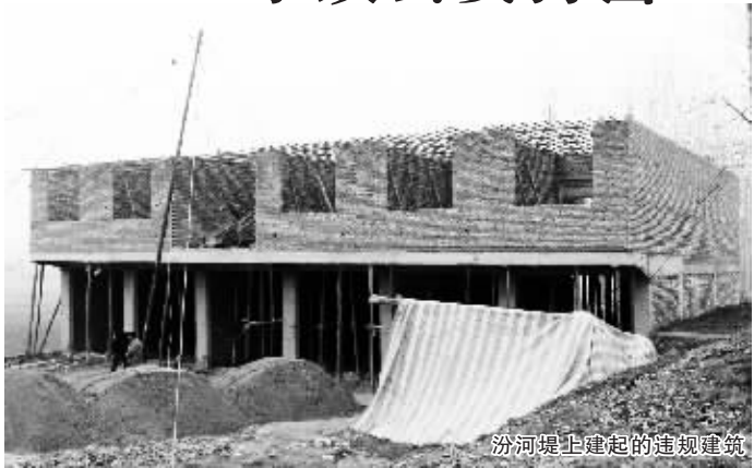
汾河堤上建起的违规建筑 该县水政监察大队相关负责人介绍,《中华人民共和国水法》
