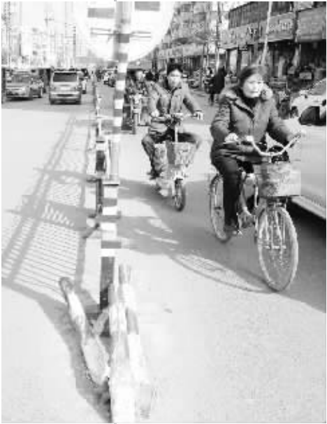
被碰坏的立柱
