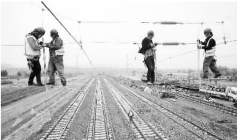
10月22日，工人在张唐铁路河北宣化县段进行电气化施工作业。
